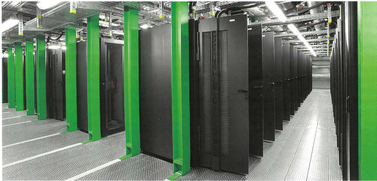
White Space des Green IT Cube am GSI in Darmstadt. Die aktiven IT-Komponenten haben im Endausbau 12 MW Leistung. (Abb. © TTSP HWP)
